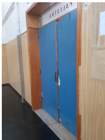
Porta di ingresso della palestra: malfunzionante e pericolante
