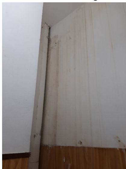
Locale tecnico piano terra: umidità ed allagamento in caso di pioggia
